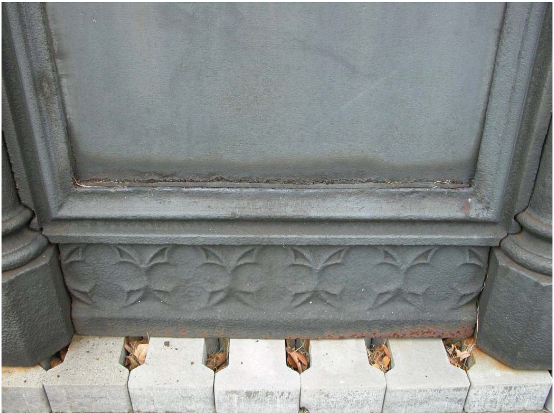
fot. 21, 22. Gliwice, GZUT. Pomnik nagrobny J. Baildona, część żeliwna. Korozja warstwowa na styku blach blend i ich obramienia. Stan w listopadzie 2010 r.
