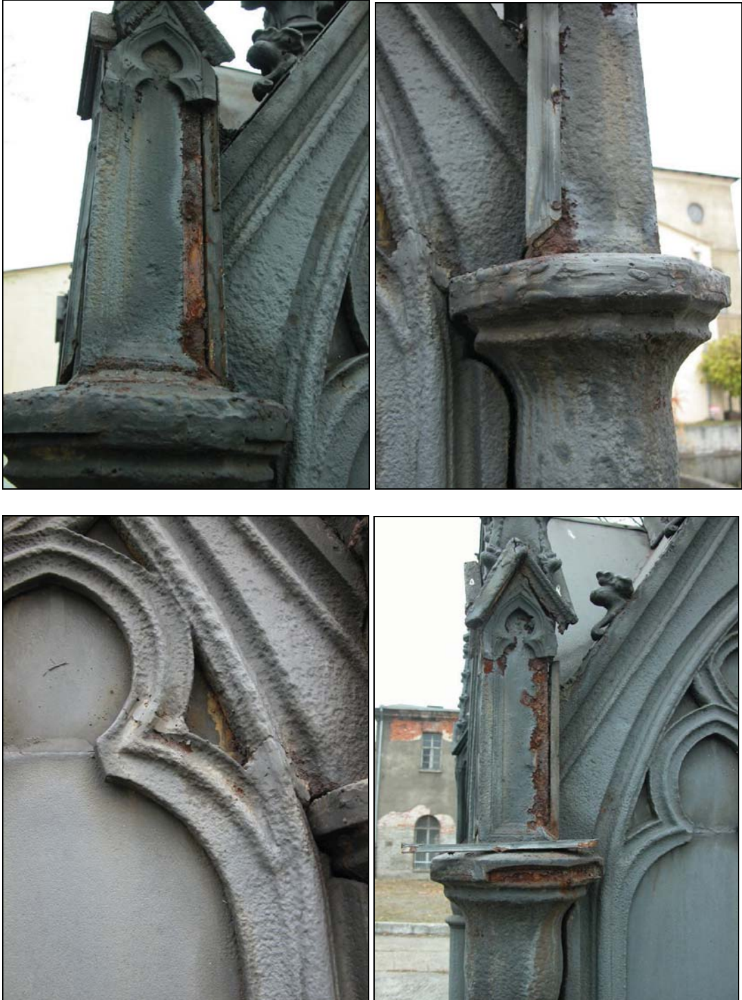
fot. 15 - 18. Gliwice, GZUT. Pomnik nagrobny J. Baildona, część żeliwna, fragmenty ze zniszczeniami będącymi efektem źle zabezpieczonych spawów, uzupełnień wykonanych metodą napawania i niedostatecznego zabezpieczenia antykorozyjnego w miejscach styku różnych metali. Stan w listopadzie 2010 r.
