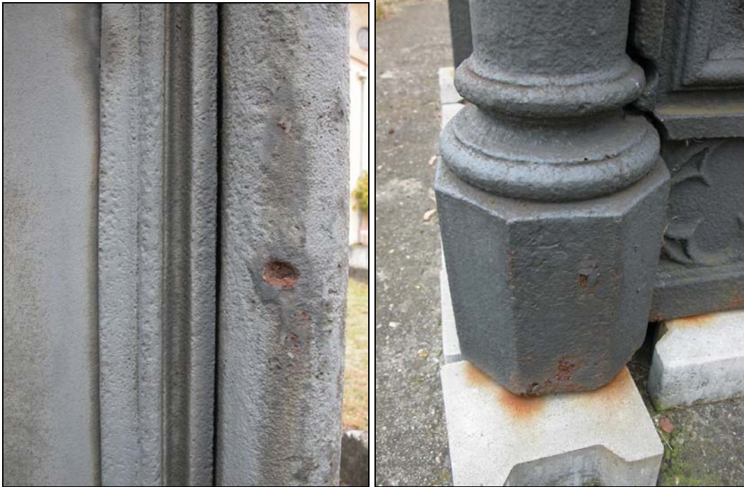
fot. 23, 24. Gliwice, GZUT. Pomnik nagrobny J. Baildona, część żeliwna. Zniszczenia korozyjne fragmentów. Stan w listopadzie 2010 r.
